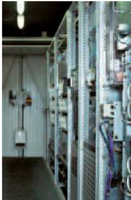
↑ Offene Elektrocontainer setzen sich immer mehr durch
