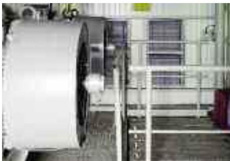
↑ Geräumigkeit im Maschinenhaus sichert gute Zugänglichkeit und Wartungsfreundlichkeit
